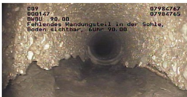
Abb. 6 (links): Abwasserversickerung durch fehlende Kanalsohle
