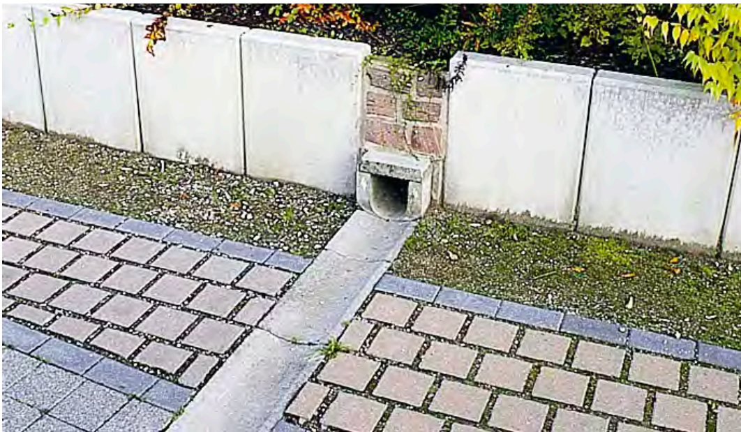
Abb.: Überlauf, Regenwasserspeicher in Mulde.
