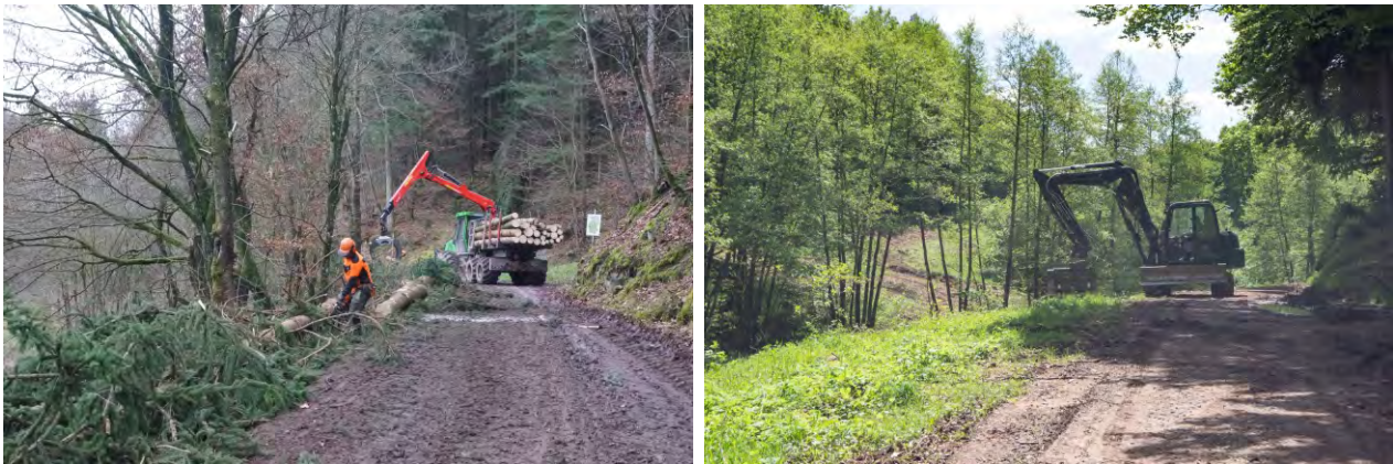
Abbildung 39: Baumfällarbeiten von Fichtenbeständen an der Talsohle und Entfernung der Wurzelstöcke zur Ermöglichung einer maschinellen Nachpflege.
