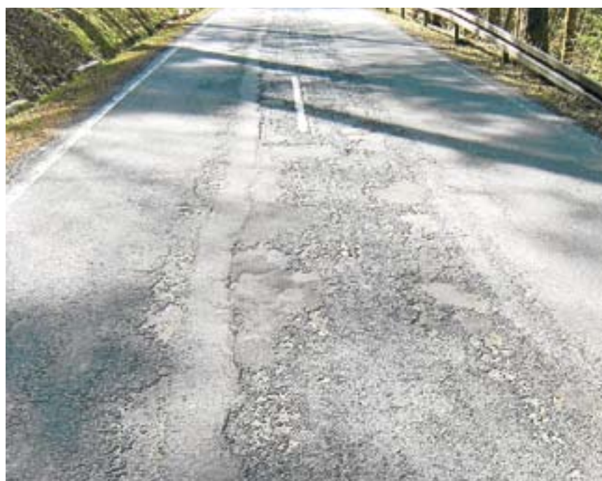
Risse und Abplatzungen in den Straßen
