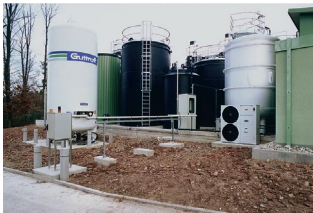
Blick auf das Tankfeld der neuen Sickerwasserreinigungsanlage
