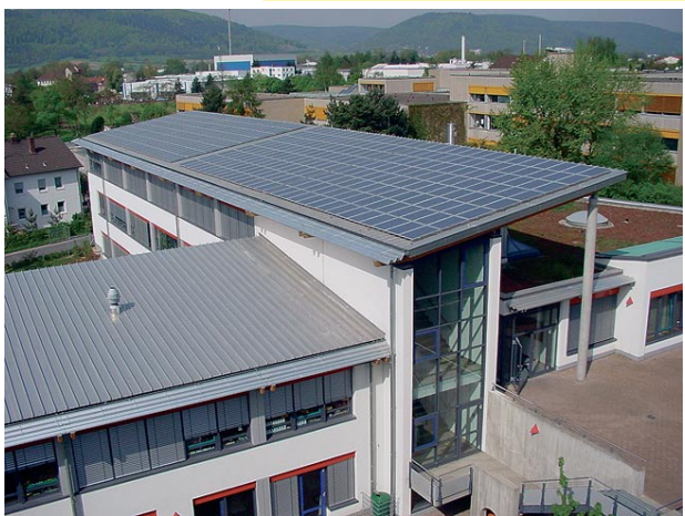
Photovoltaikanlage auf der Heinrich-Ernst-Stötzner-Schule in Miltenberg, die im Mai 2001 in Betrieb ging.
