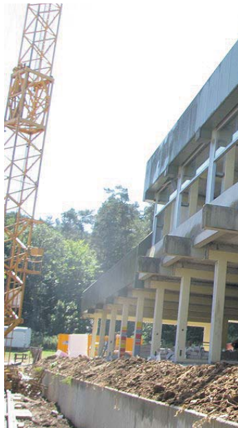
Der dritte von insgesamt fünf Bauabschnitten bringt der Realschule den erwarteten Start der Generalsanierung des vorhandenen Bestands.
